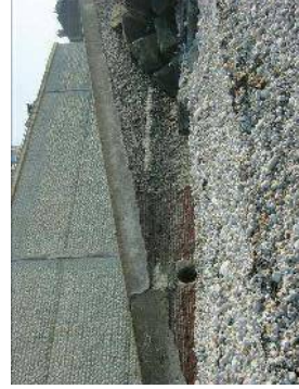
Figure 5 : Vue des deux exutoires après le « coup de vent »
